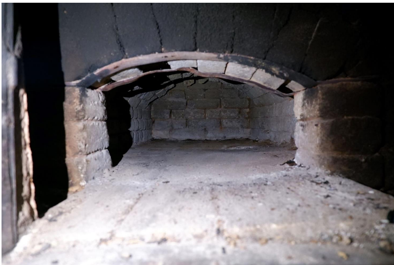
Lielvēveru krāsns kurtuve un tās priekštelpa pirms restaurācijas 2022. gadā. M. Varbūta foto.
